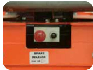
Soupape de décharge manuelle (conduite hydraulique)
